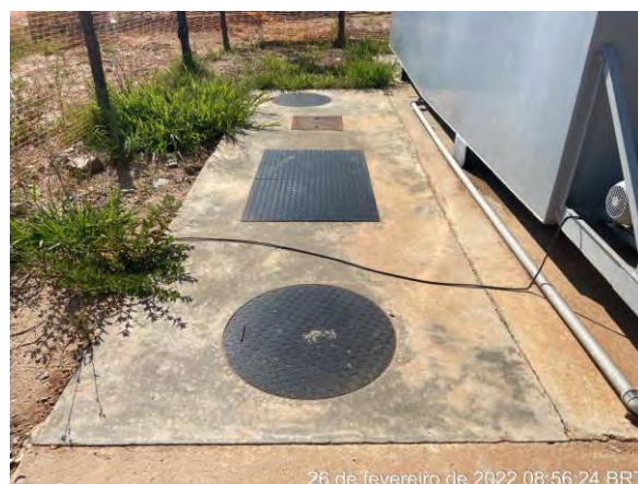
Foto 313 – Vistoria - Caixa SAO do tanque de combustível. (Data: 26/02/2022)
