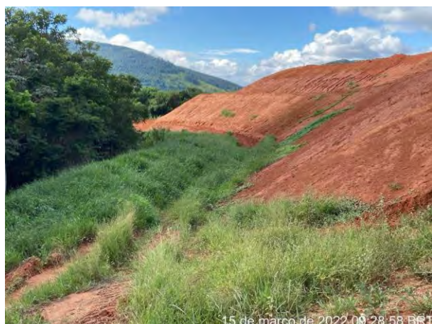
Foto 216 – Canaleta e leira de proteção no entorno do bota espera com inclinação para a saia do talude. (Data: 15/03/2022)
