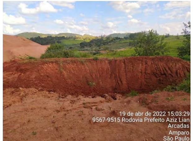
Foto 227 – Cacimba de retenção de sedimento. (Data:19/04/2022)
