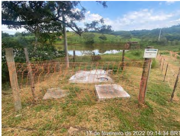
Foto 320 – Monitoramento dos biodigestores do Administrativo. (Data: 17/02/2022)
