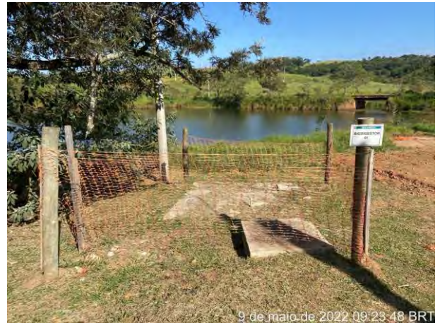
Foto 327 – Biodigestores do canteiro administrativo. (Data: 09/05/2022)
