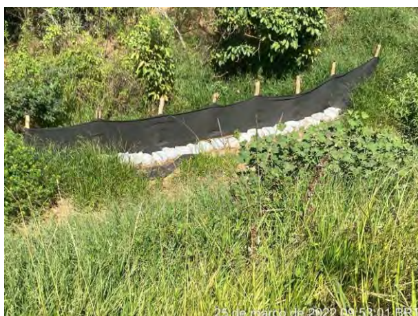
Foto 276 – Barreira de retenção de sedimentos. (Data:25/03/2022).
