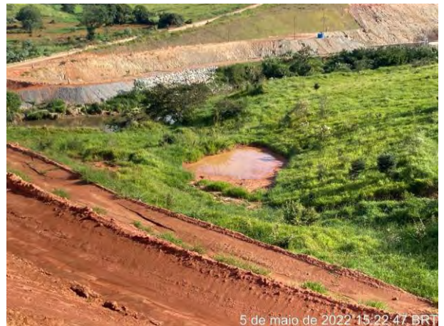
Foto 229 – Cacimba de retenção de sedimento. (Data:05/05/2022)
