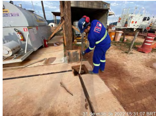
Foto 319 – Limpeza da caixa de inspeção e canaletas da área de manutenção. (Data: 31/05/2022)
