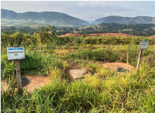
Foto 326 – Biodigestores do canteiro industrial. (Data: 27/05/2022)
