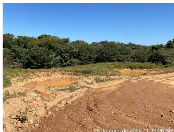
Foto 289 – Cacimba de retenção de sedimento. (Data: 25/05/2022)
