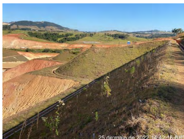
Foto 300 – Grama e canaleta de drenagem. (Data:25/05/2022)
