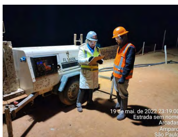
Foto 144 – Check list equipamento torre de iluminação. (Data: 19/05/2022)
