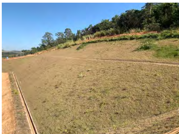
Foto 301 – Grama e Canaletas de drenagem. (Data:18/05/2022)
