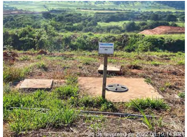
Foto 321 – Biodigestores do canteiro Industrial (Data: 21/02/2022)
