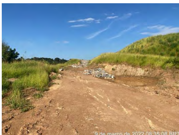
Foto 247 – Leira e canaletão para retenção de material e disciplinamento do fluxo para as caixas de retenção. (Data: 09/03/2022)
