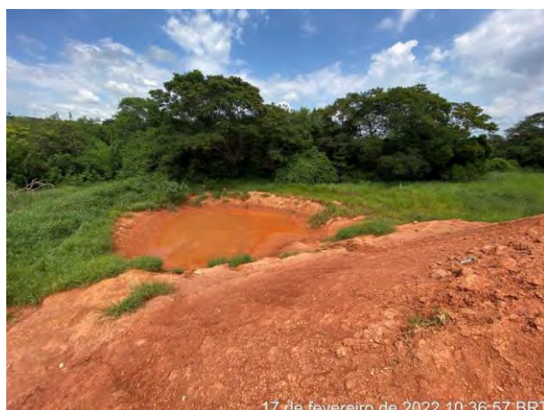
Foto 214 – Cacimba de retenção de sedimento. (Data:17/02/2022)
