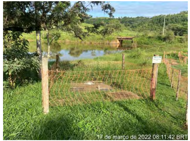
Foto 323 – Biodigestores do canteiro administrativo. (Data: 17/03/2022)
