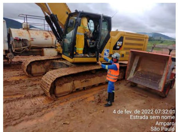
Foto 138 – Check list equipamento. (Data: 04/02/2022)
