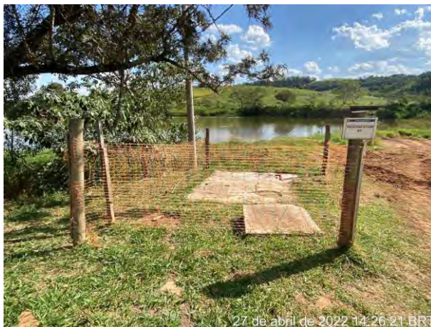
Foto 324 – Biodigestores do canteiro industrial. (Data: 27/04/2022)
