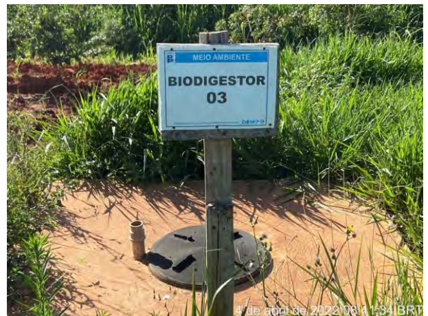
Foto 325 – Biodigestores do canteiro administrativo. (Data: 04/04/2022)
