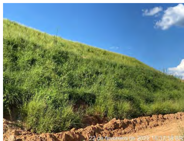
Foto 242 – Leira e canaletão para retenção de material e disciplinamento do fluxo para as caixas de retenção. (Data: 22/02/2022)
