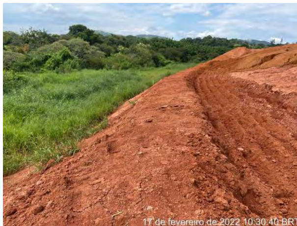
Foto 210 – Canaleta e leira no entorno do BE com inclinação para a saia do talude. (Data: 17/02/2022)
